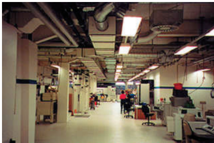
Lufttechnische Anlage für ein Foto-Großlabor mit besonderem Brandschutz für die Entrauchungsanlage
