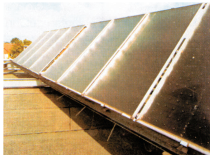
Solaranlage mit 24 Modulen auf dem Dach des Verwaltungsgebäudes der Stiftung Volkswagenwerk in Hannover-Döhren
