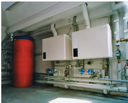
Ein moderner Gas-Brennwertkessel
